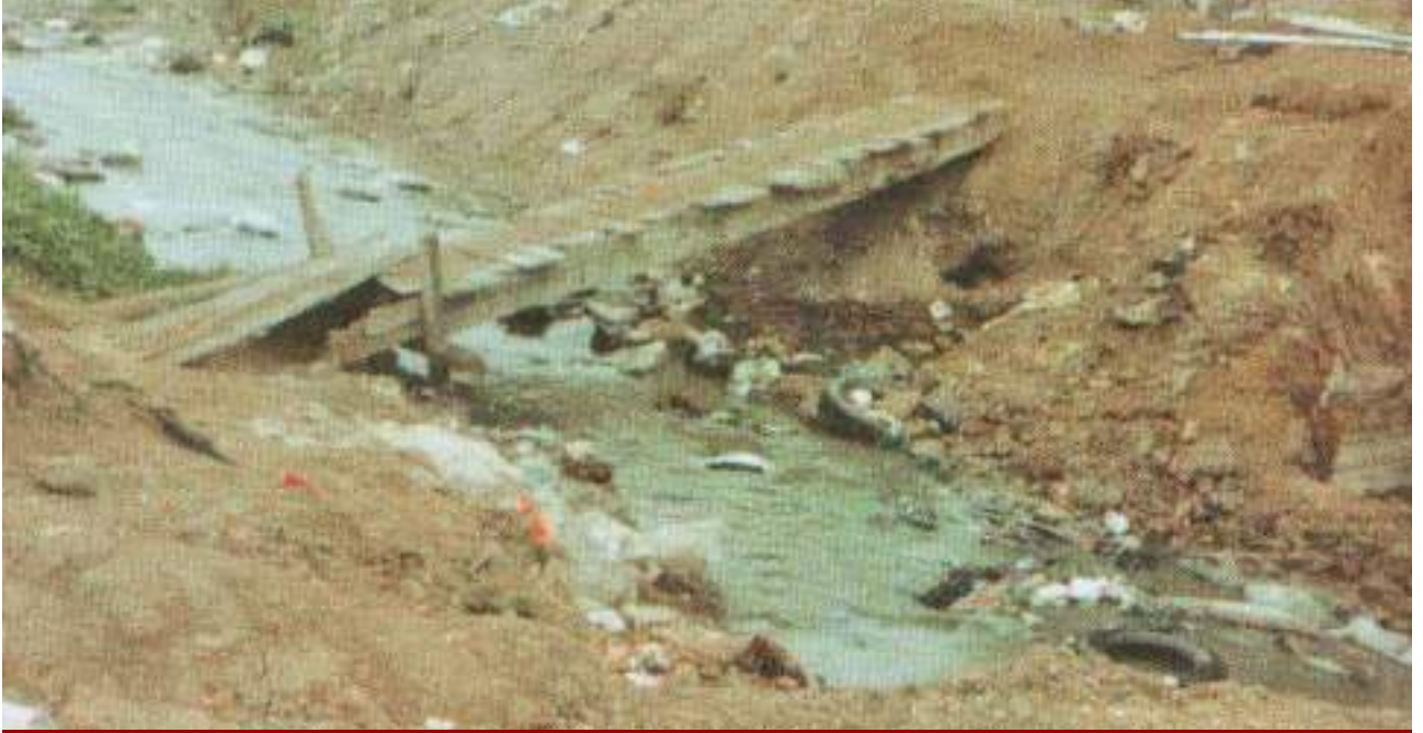
Tavukçu Deresi üzerine derme-çatma yapılmış köprülerden biri (Bağcılar Belediyesi Arşivi)
